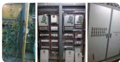
Rekonstrukcija komandnog pulta silosa
